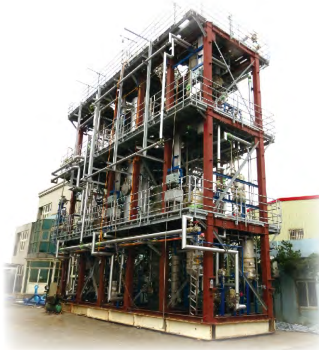
溶劑回收蒸餾設備
